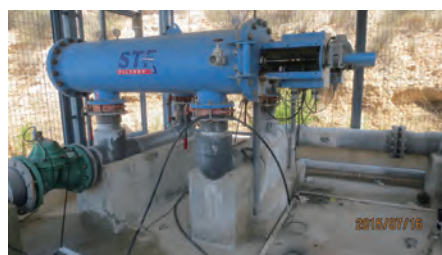
▲第一道粗過濾設備
