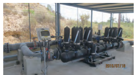
▲第二道過濾設備
