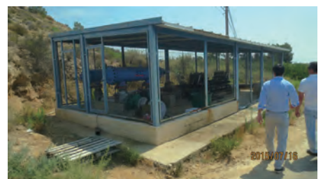
▲家庭廢水回收大型過濾站
