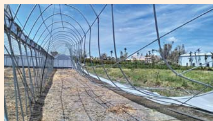
▲溫室內部無補強結構損壞案例多
