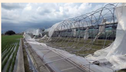
▲溫室設施受強颱侵襲結構嚴重坍塌
