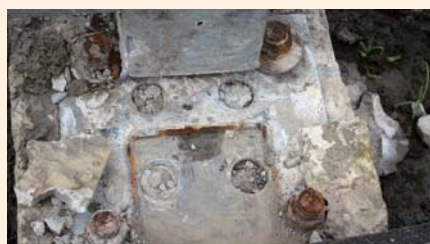
▲由設施基礎柱之焊接處斷裂
