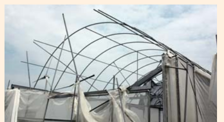
▲由管件接合零件處鬆脫破壞
