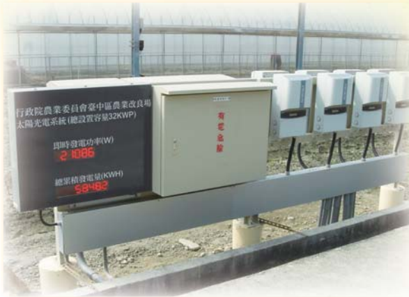
▲戶外型LED展示板及直流轉換器等電控設備
