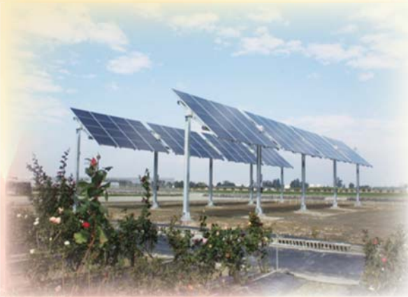
▲建置完成之地面高架追日型太陽能發電系統
