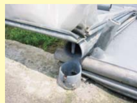
▲管材鑽孔處斷裂情況(中興大學黃裕益教授提供)
