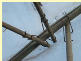
▲彈簧夾老舊生鏽情況，管材與塑膠膜接觸有摩擦破損可能
