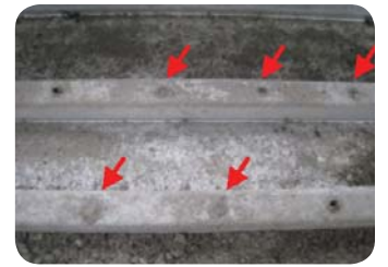
圖4. 堵塞的供水孔洞
