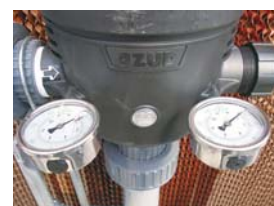
進出水口處壓力計
