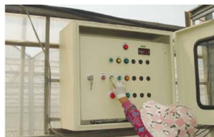
圖四、升降網架系統之電控裝置，具有手動、自動各二種操作方式供選用
