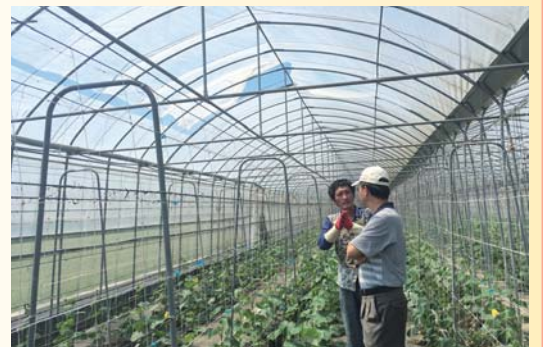
▲於溪州鄉黃金廊道節水溫室與陳蒼駝農友討論設施損害及結構補強問題（陳蓓玲提供）
