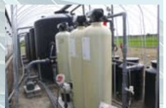
▲試驗區之雨水儲存桶與過濾裝置
