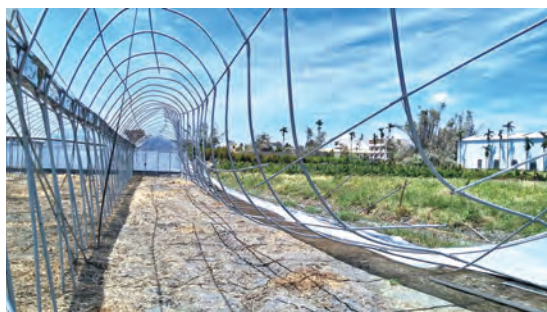
簡易溫室結構管件彎曲坍塌
