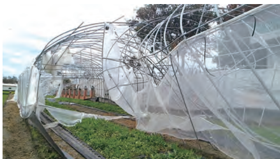
簡易溫室結構管件主柱拔起損壞
