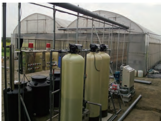
連棟溫室之雨水收集、水質處理與肥灌系統
