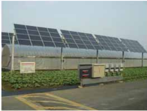
太陽能發電系統結合設施生產
