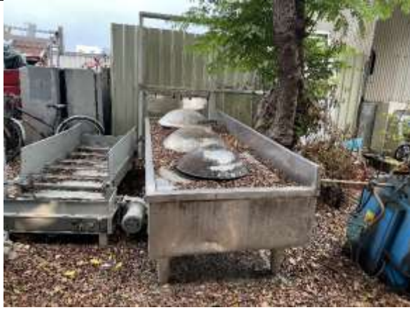
廚房爐台及排煙處理機
