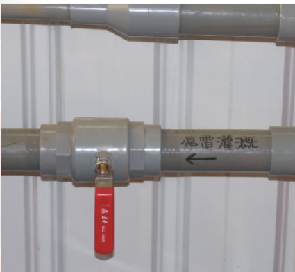
設計停電亦可供水系統
